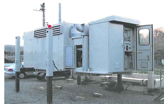
自揚型移動式発電装置 6,600V 500KVA
